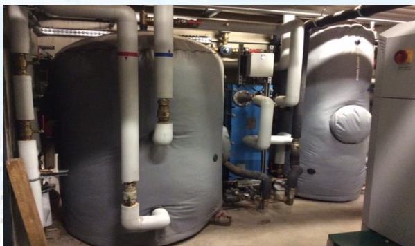
Ballon solaire et échangeur
